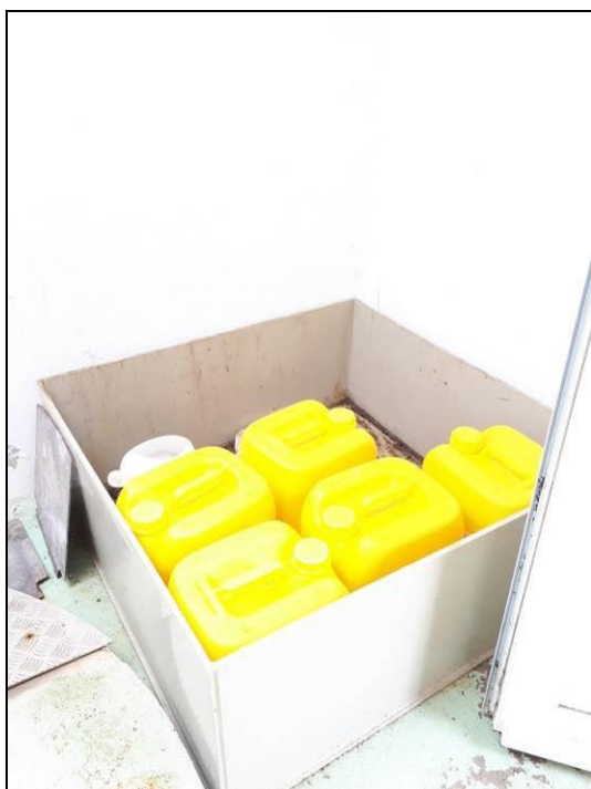
Stockage d'hypochlorite de sodium
